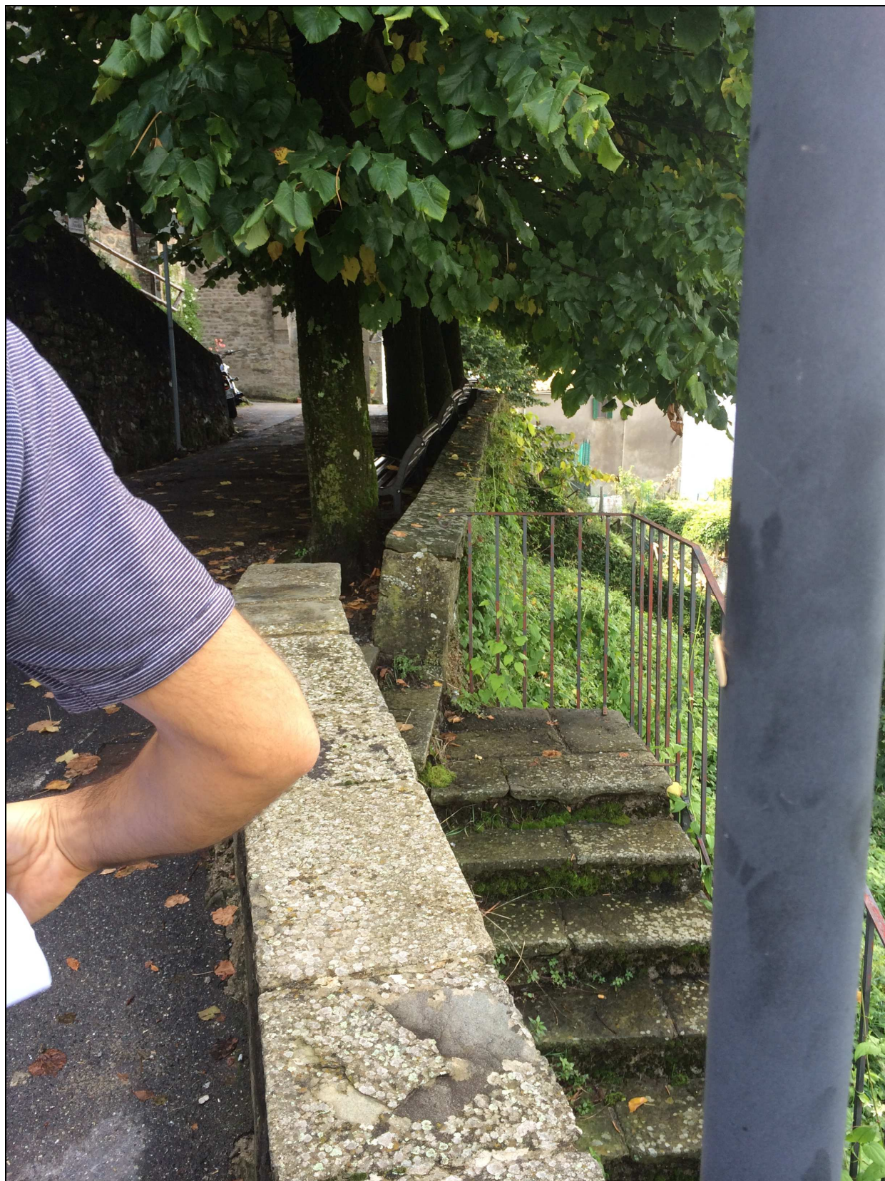
Foto n. 1 Muro Lesionato in crisi su Via delle Mura
