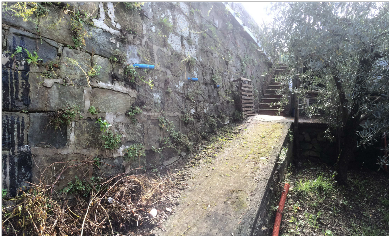
Foto n. 5 Piede del Muro di retta alla Viabilità PROVINCIALE in loc. Borgo G. Matteotti.
