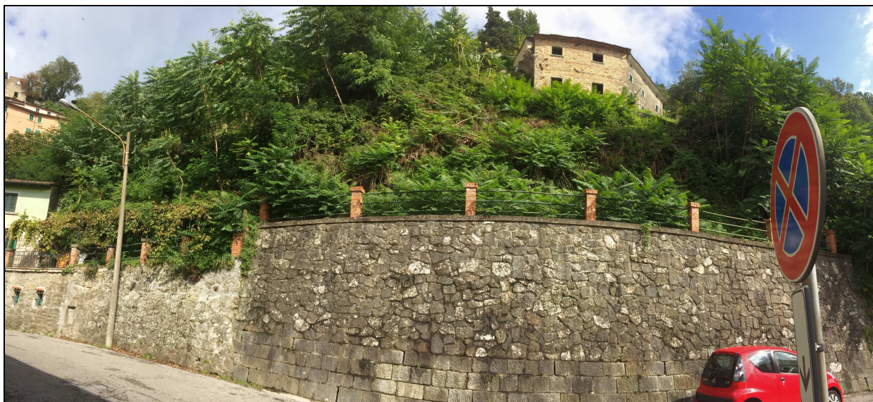
Foto n. 4 Dissesto di crollo detritico a Monte della Via PROVINCIALE
