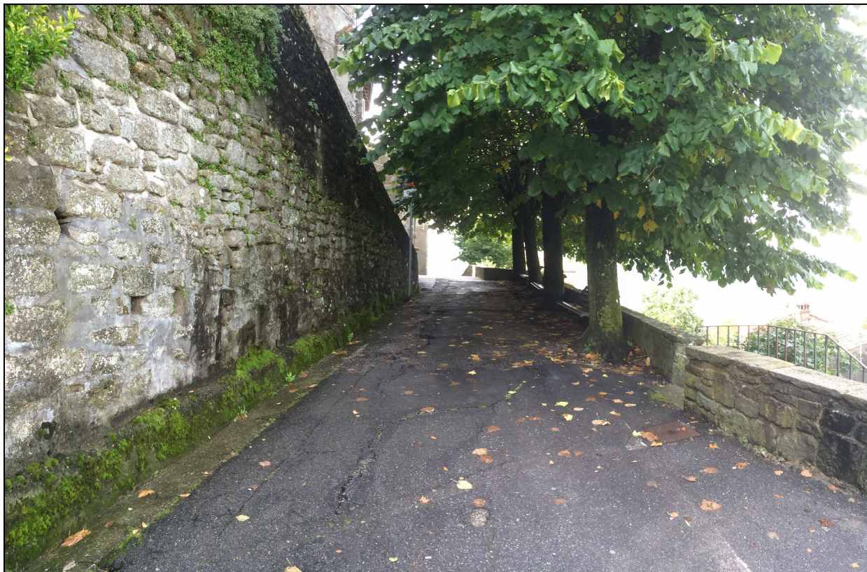
Foto n. 3 Muro Lesionato in crisi su Via delle Mura
