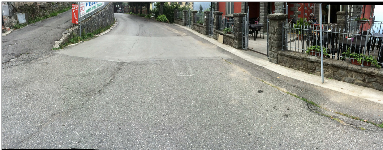
Foto n. 9 Avvallamenti e lesioni su Via PROVINCIALE in loc. Borgo G. Matteotti
