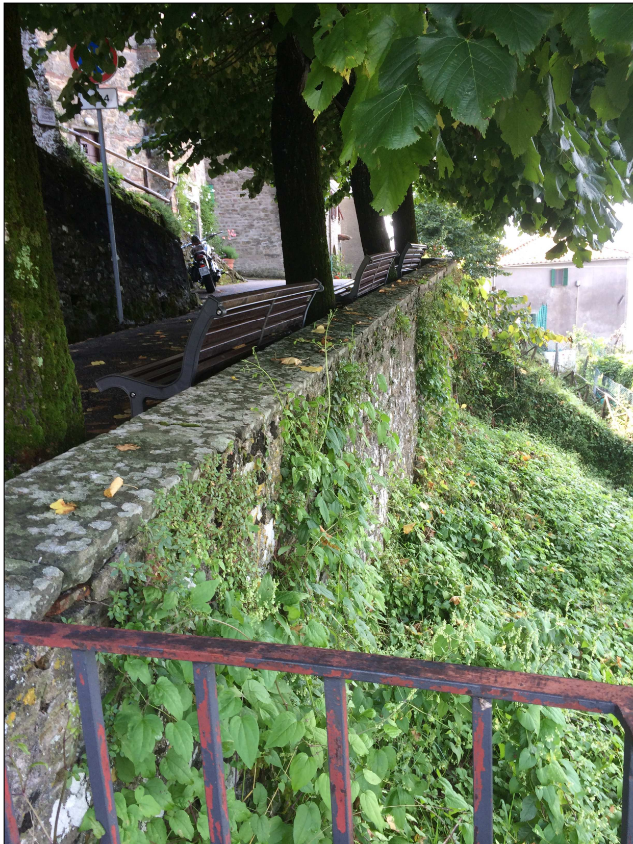
Foto n. 2 Muro Lesionatoe in crisi su Via delle Mura
