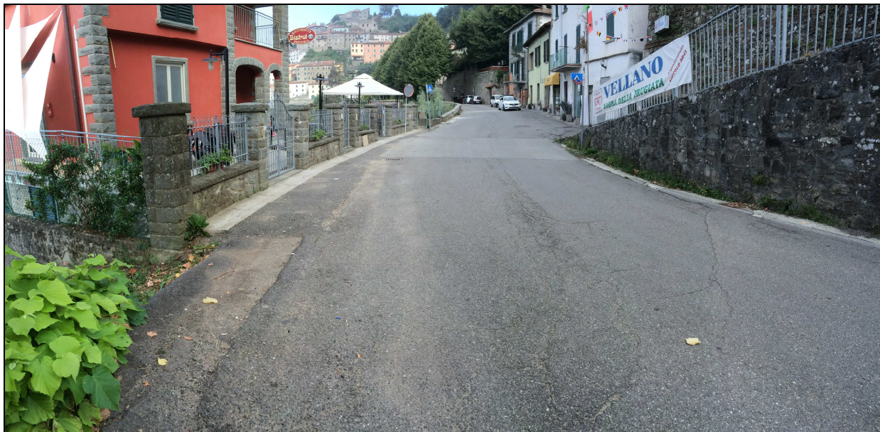
Foto n. 11 Avvallamenti e lesioni su Via PROVINCIALE in loc. Borgo G. Matteotti
