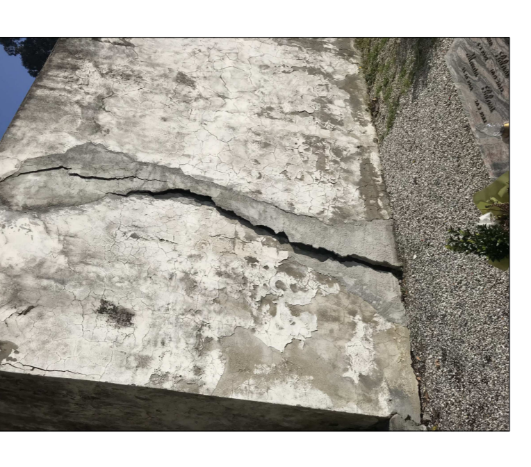
Foto 3: lesione verticale sul muro interno di presidio generale con sfollamento in tre diverse parti.
