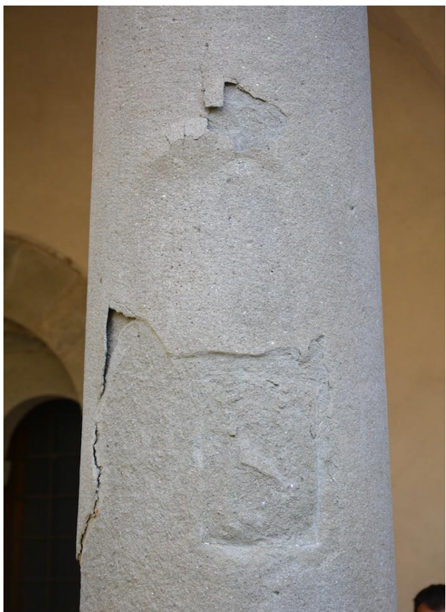
Particolare delle lesioni
