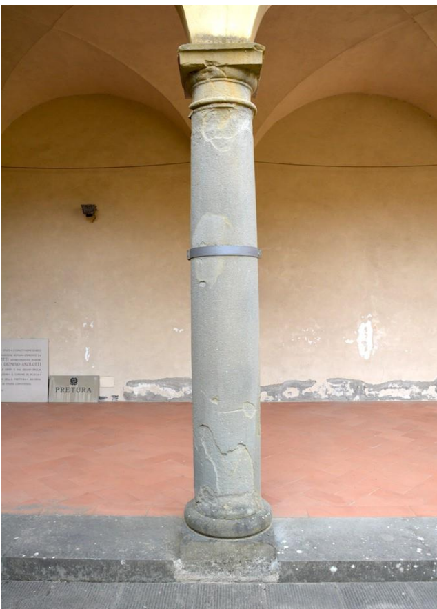
Lesioni superficiali presenti su una delle colonne del Chiostro A
