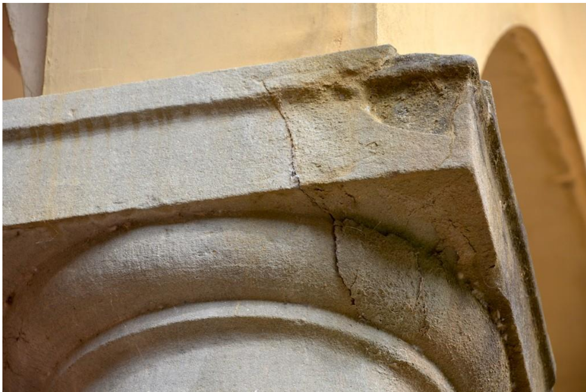
Particolare di un capitello eroso dalle acque meteoriche
