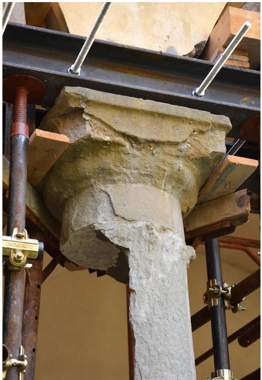
La Colonna 10 che ha subito il crollo
