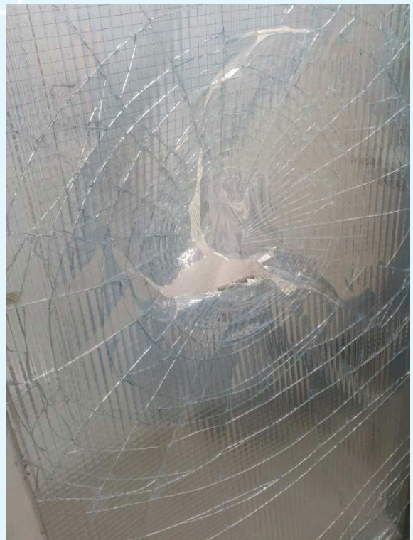
Esempio di rottura non conforme a 1200 mm.
