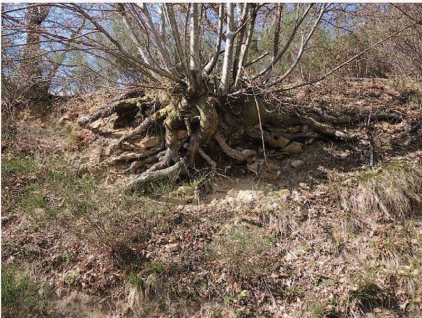
Foto 3 – Scarpata soprastrada in ambiente forestale con evidenti segni di erosione alla base di una ceppaia di castagno.
