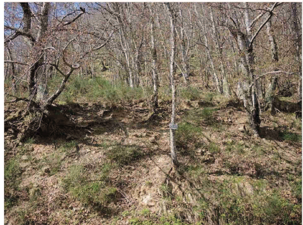
Foto 2 – Scarpata soprastrada ambiente forestale con evidenti segni di erosione.
