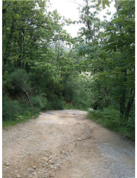
Foto 51 solchi di erosione sulla sede viaria
