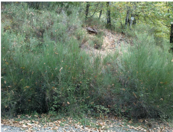
Foto 6: scarpata in erosione
