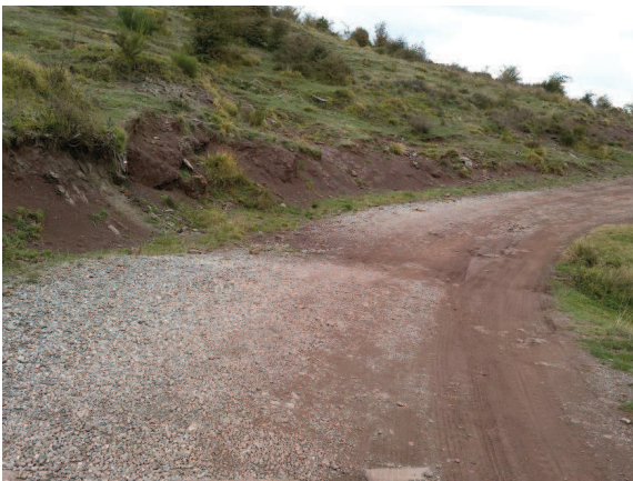
Foto 14: necessità di realizzazione guado
