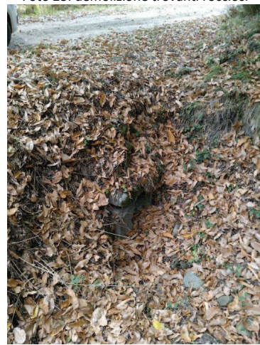
Foto 24: attraversamento da riaprire
