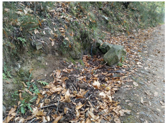
Foto 8: Pozzetto ed attraversamento da rifare
