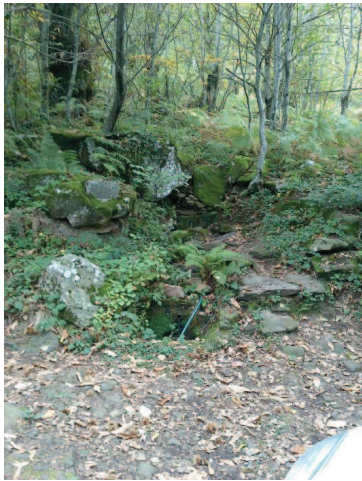
Foto 37 attraversamento da rifare
