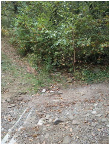
Foto 29: attraversamento da rifare con intercettazione acque da fossetti
