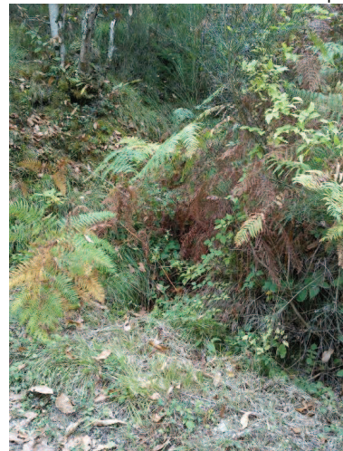
Foto 48: attraversamento da fare e fossetto da regimare
