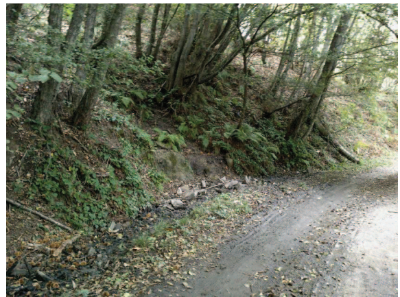
Foto 28: scarpata di monte con sorgenti da captare e regimare Canaletta da aprire e attraversamento da fare
