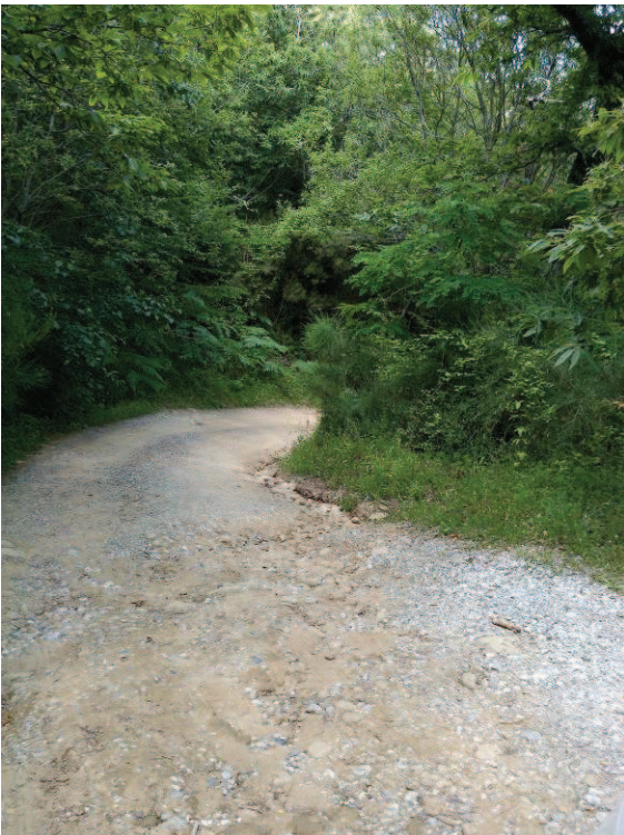
Foto 54 solchi di erosione sulla sede viaria
