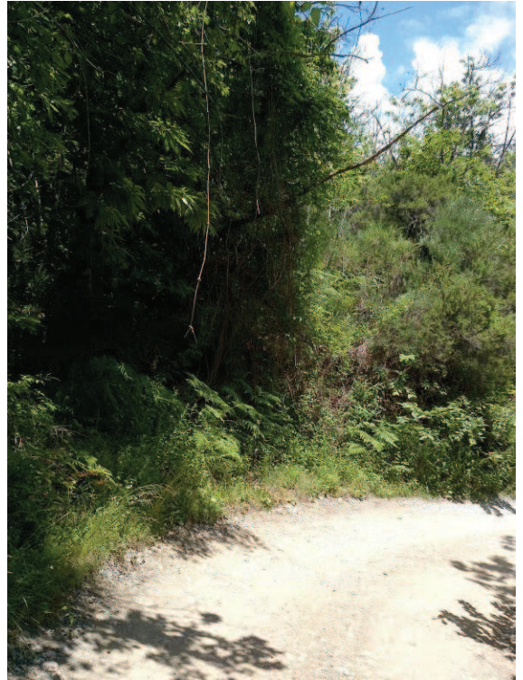
Foto 55 erosione sulla sede viaria e canaletta da aprire
