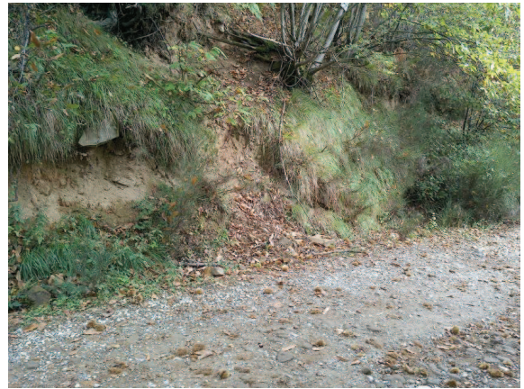
Foto 7: scarpate con modesti crolli su cui realizzare palizzate
