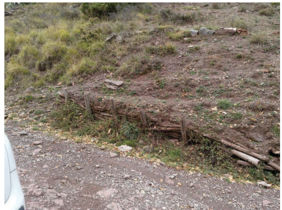
Foto 12: canaletta da fare e palizzate da ricostruire
