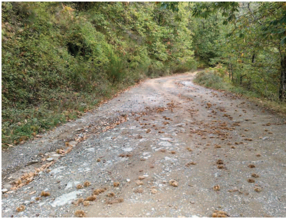
Foto 5: solchi di erosione per ruscellamento
