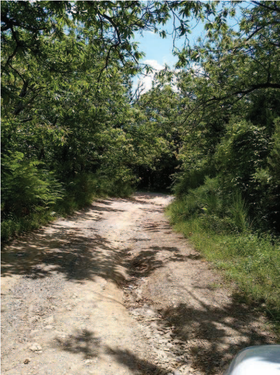
Foto 49 solchi di erosione sulla sede viaria
