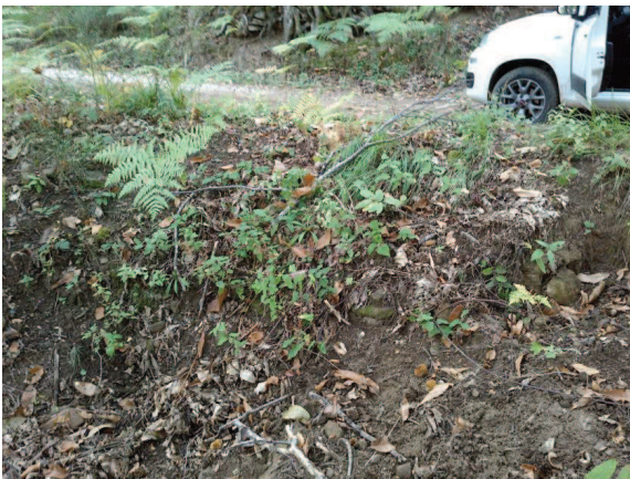
Foto 42 attraversamento da riaprire ormai otturato
