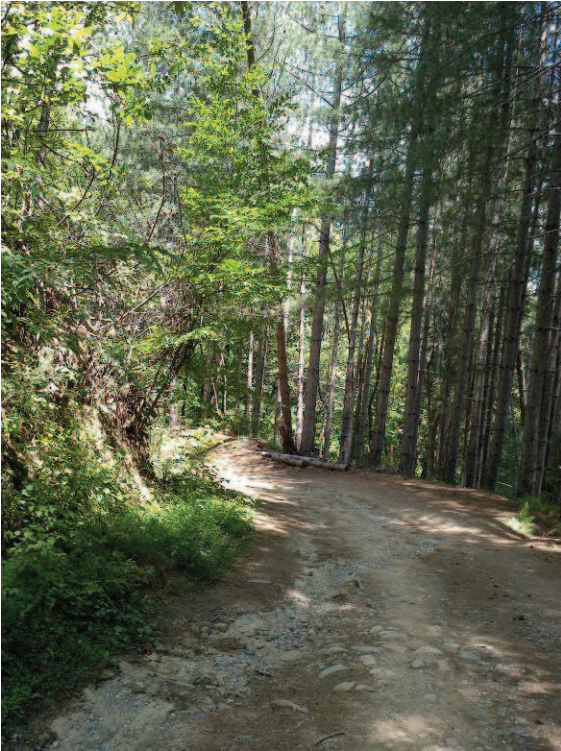
Foto 57 solchi di erosione sulla sede viaria e piante da tagliare a rischio crollo sulla viabilità
