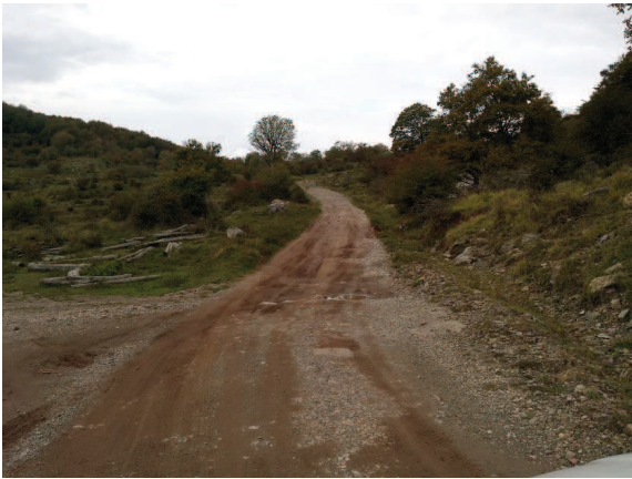
Foto 17: attraversamento sa rifare e canaletta da aprire
