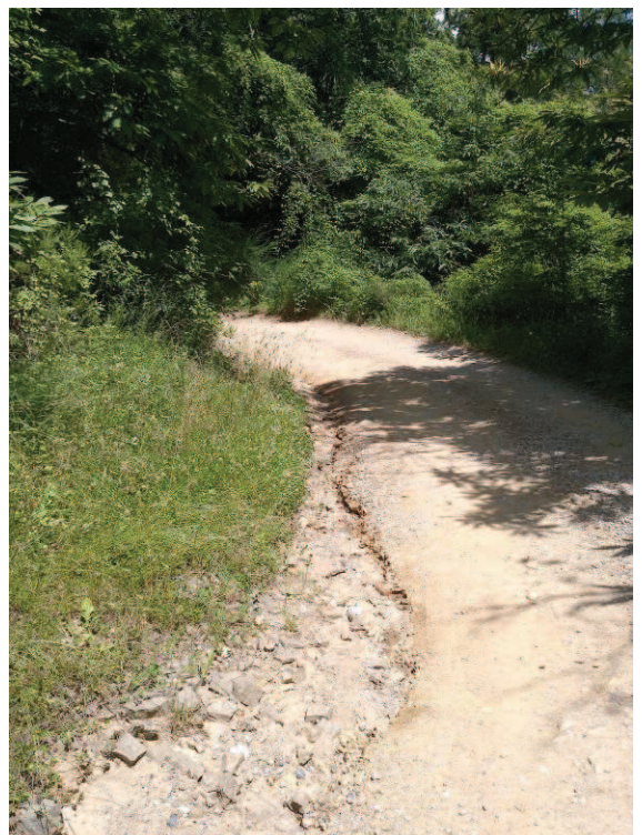
Foto 56 solchi di erosione sulla sede viaria
