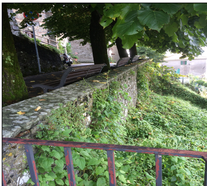
(Foto n. 2) Muro Lesionatoe in crisi su Via delle Mura
