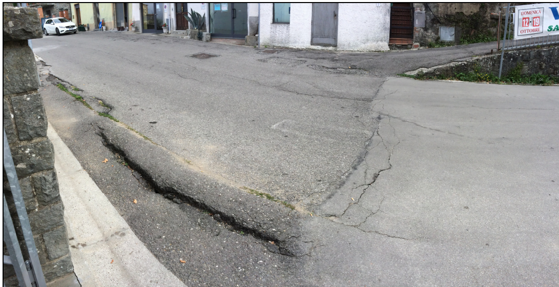
(Foto n. 10) Avvallamenti e lesioni su Via PROVINCIALE in loc. Borgo G. Matteotti
